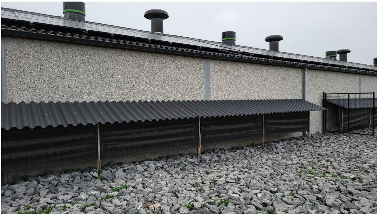
Afdaken aan kippenstal te regulariseren
