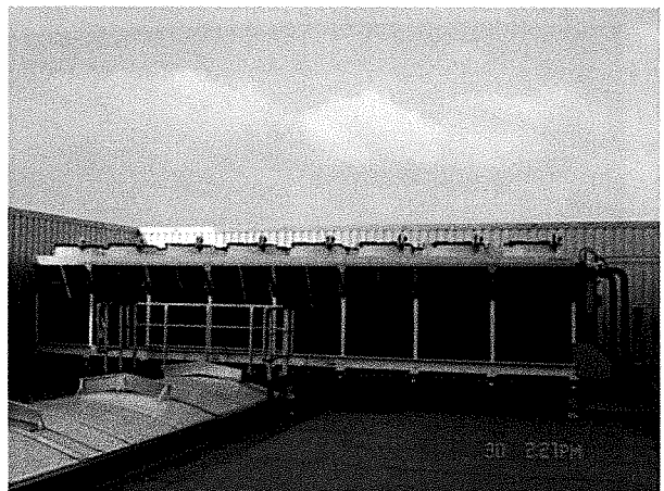
Droge koelers 1 - 8 x 2 ventilatoren
