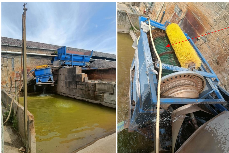
Figuur 10: lavawasser met aangebrachte rubberen mat in de wastrommel
